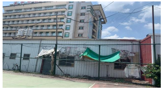
說明：圍網破損
