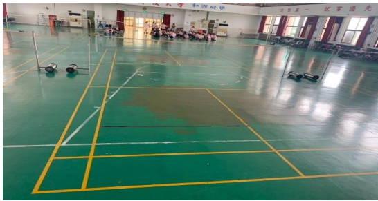
說明：PU 多處磨損
