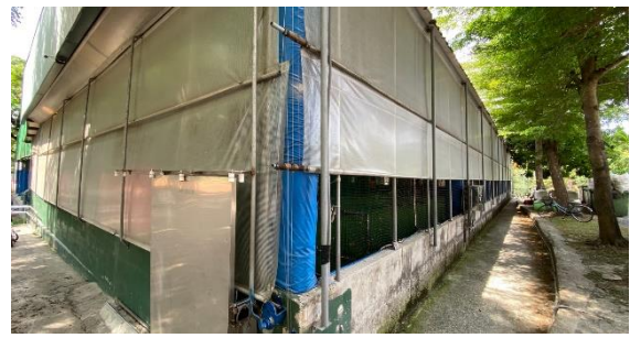
說明：圍網破損
