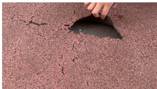
說明：PU 跑道多處破裂
