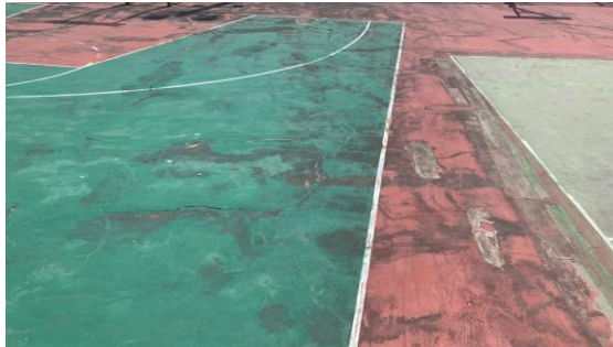
說明：說明破損情形
