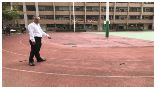
說明：說明破損情形
