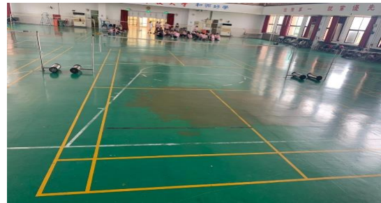
說明：PU 多處磨損
